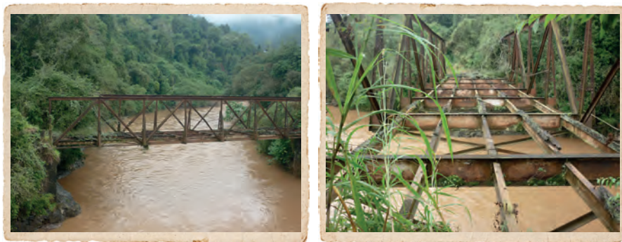
A ponte em 17/07/2015, com 81 anos e, abandonada
